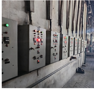
Gambar 5- Alat Pengontrol Setiap Ruang Oven
