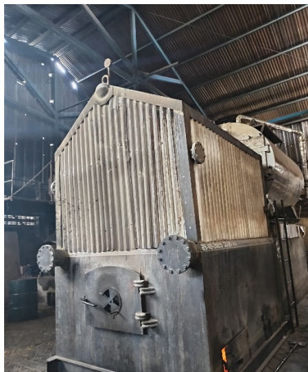
Gambar 1 - Mesin Boiler Di PT. Wonojati Wijoyo
