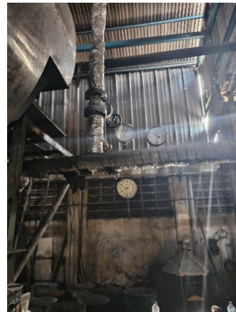
Gambar 3 - Pipa Radiator Yang Terhubung Dari Boiler Ke Ruang Oven
