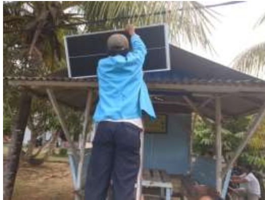
Gambar 12. Peamasanga Mini Power Plant di Lokasi
